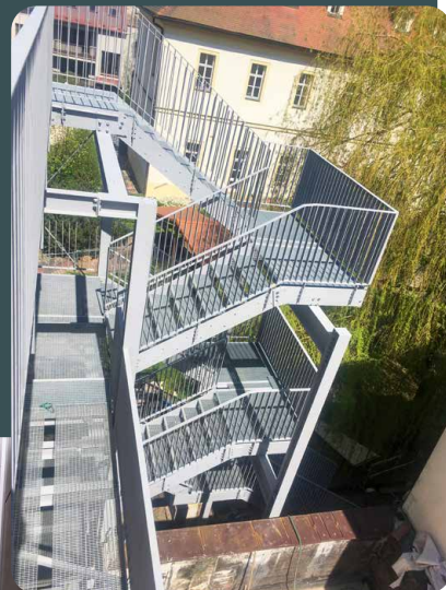
Venkovní ocelové únikové schodiště domu s pečovatelskou službou, Mladá Boleslav
