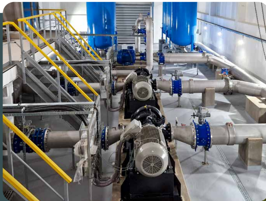
Čerpací stanice pitné vody, Hustouň
